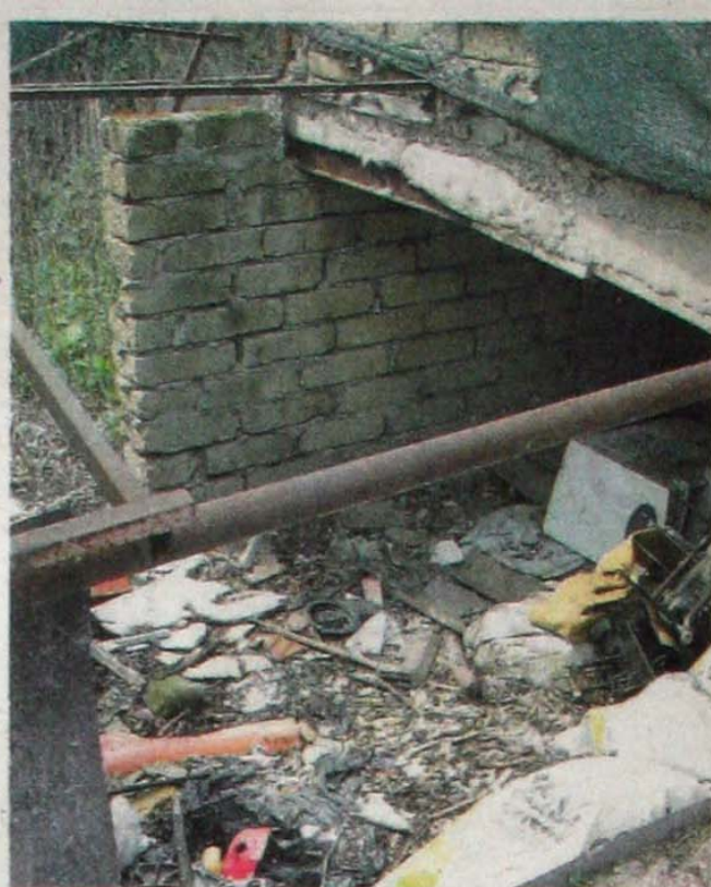
I rifiuti Una panoramica della discarica
